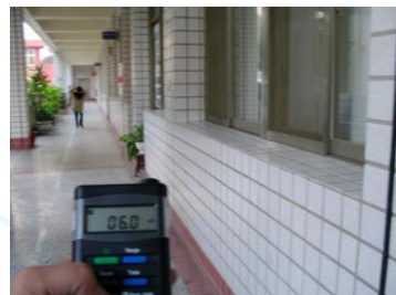
天花板有高壓電纜 走廊6.0mG
