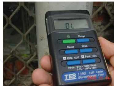
接近高壓電纜 超過2000mG
