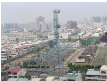
仁和路變電所
