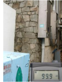
大同路二段449巷4號住家後變 電箱纜線 99.9mG
